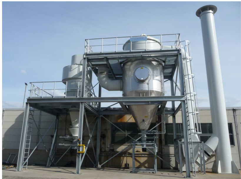
Abb. 4: Abluftreinigungsanlage nach ATEX
